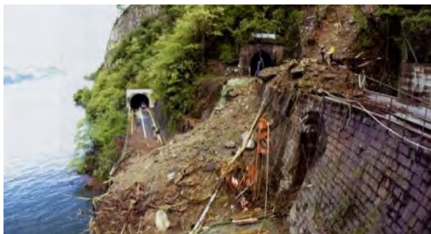
Foto - Frana del maggio 2002 abbattutasi sulla linea ferroviaria e sulla SS394 – fonte www.astrogeo.va.it
