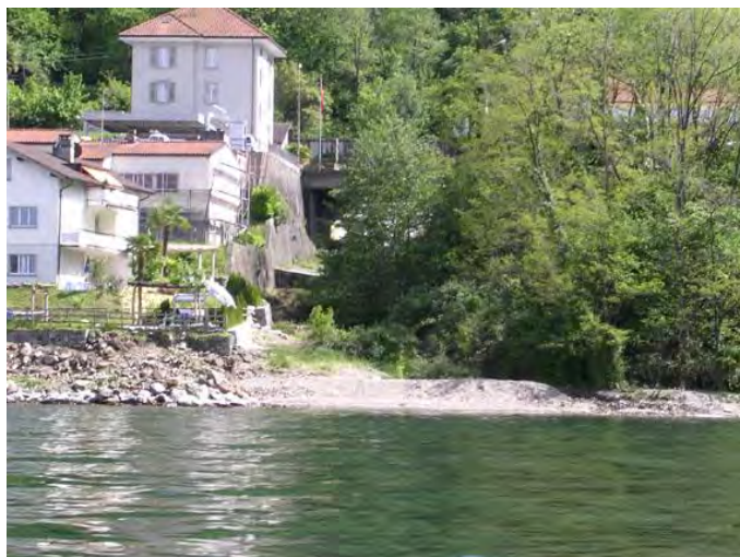
Foto - Foce del Rio Dirinella. Le case in sponda idrografica destra sono in territorio elvetico. Si noti la consistente crescita arborea sul letto del rio in secca, che potrebbe ostacolare il regolare deflusso delle acque.
